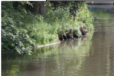
Foto: oever met metselwerk in verval
